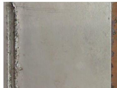
(b) 焊缝存在沟槽现象
