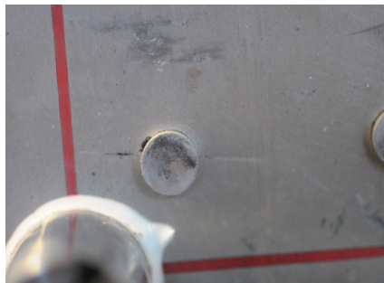
图8 141200次循环时出现的裂纹形貌图
