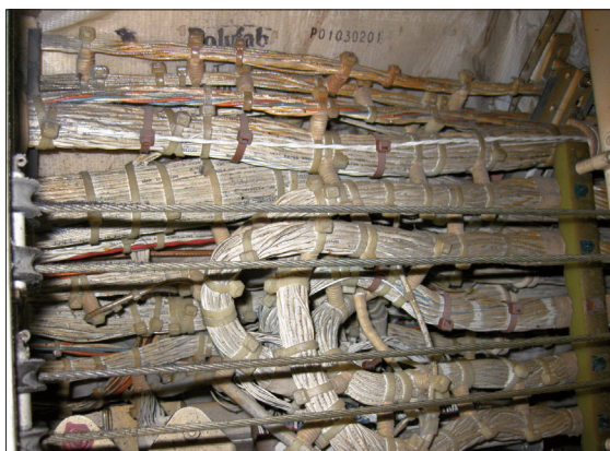
图2 导线装配不好容易磨损的区域
